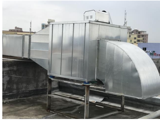
油烟废气排气口
