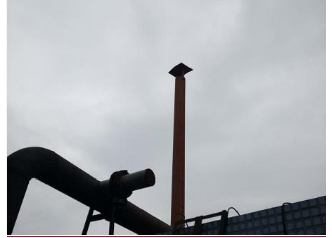
天然气废气排放口
